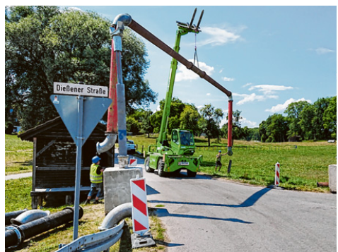
Die Zufahrt nach Bierdorf wird durch eine Rohrbrücke mit einer Durchfahrthöhe von 4,80 Meter freigehalten. Foto: Ammerseewerke
